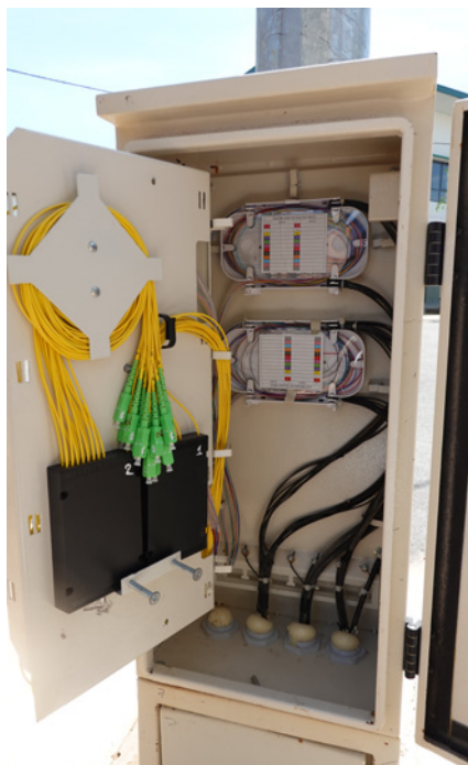
Tủ Cabinet tại khu Oasis Mỹ Phước
